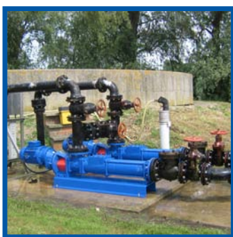
Перекачивающие насосы для осадка на станции обработки сточных вод
